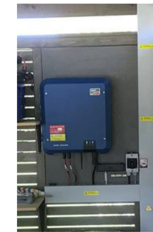
Wechselrichter im Carport montiert
